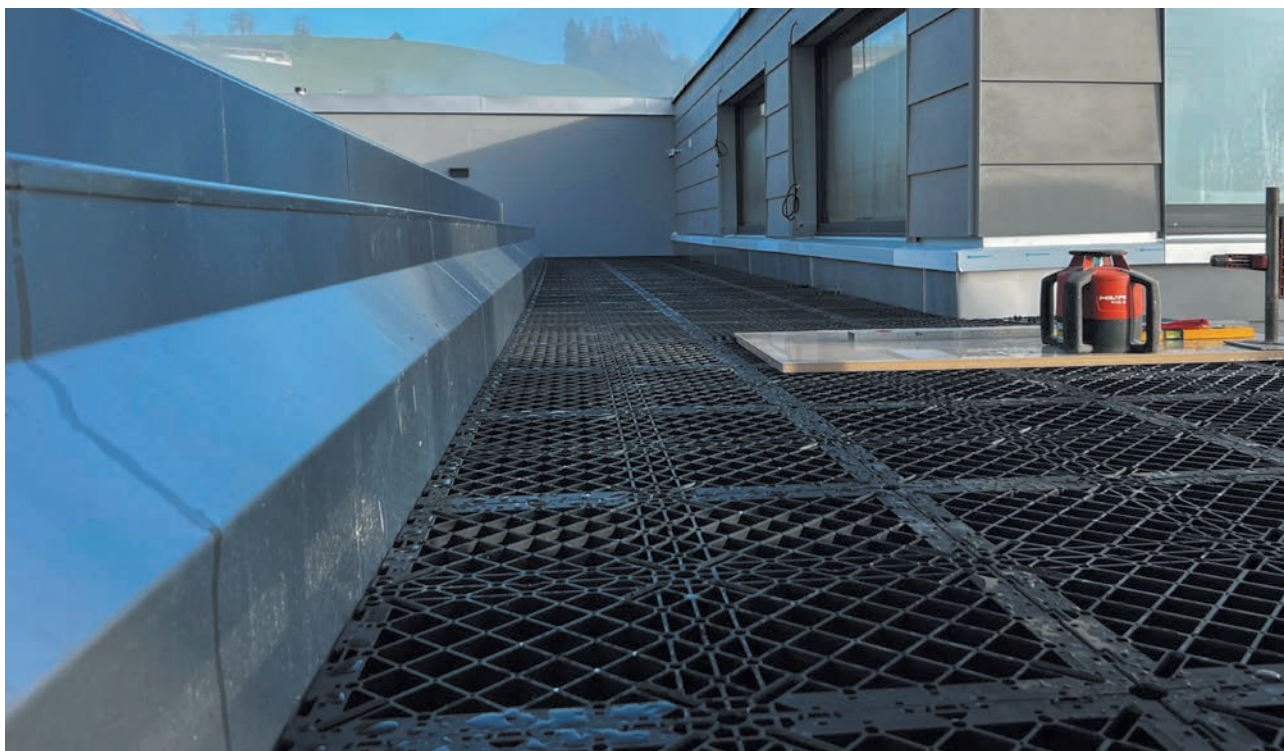
Villa privata – Rooftop, terrazze e aree esterne Svizzera Pedestal System – Pedestal Prime® con GRF System
